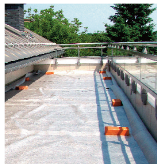
3 Geowłókna zabezpieczająca przed przerastaniem korzeni
